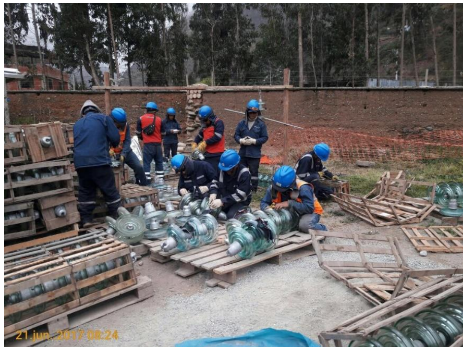
Imagen N° 39 ensamblaje de aisladores, localidad C.C. Palca, Distrito de Palca Provincia de Tarma
