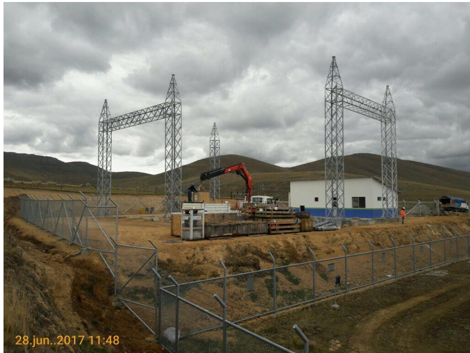
Imagen N° 17 Trabajos de construcción de la Sub Estación Caripa, localidad perteneciente a la SAIS Tupac Amaru, Distrito de Palca, Provincia de Tarma.
