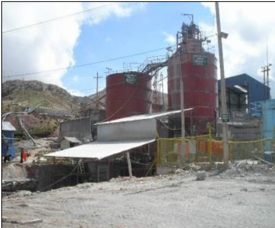
Fotografía N° 4: Planta de relleno hidráulico de la Mina Animón
