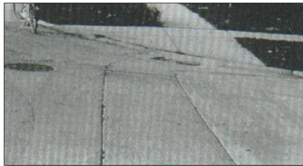
Imagen 32. Parche grande y acometidas de servicios públicos de baja severidad.
