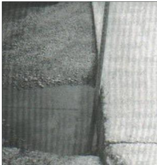
Imagen 28. Desnivel carril / berma de alta severidad.
