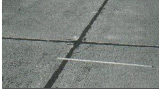
Imagen 51. Descascaramiento de esquina de baja severidad.
