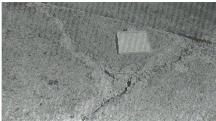
Imagen 13. Grieta de esquina de alta severidad.
