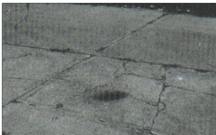
Imagen 16. Losa dividida de alta severidad.
