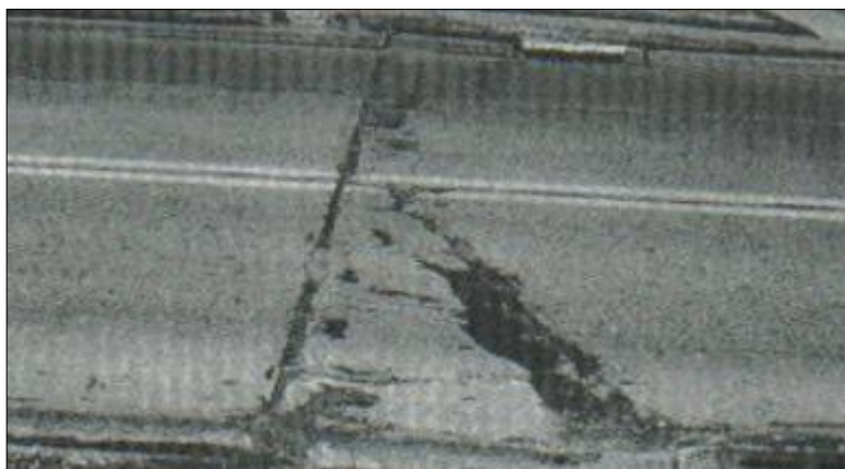
Imagen 42. Punzonamiento de severidad media.
