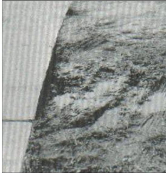
Imagen 27. Desnivel carril / berma de severidad media.
