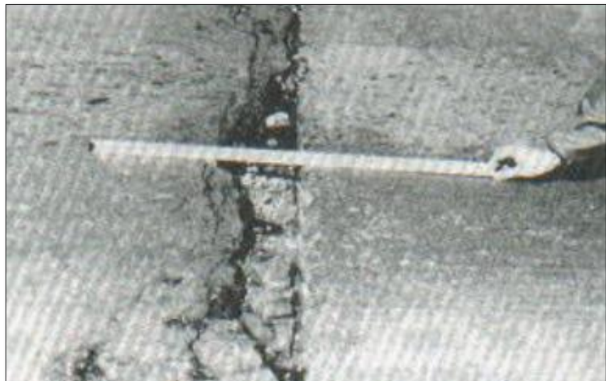
Imagen 56. Descascaramiento de junta de alta severidad
