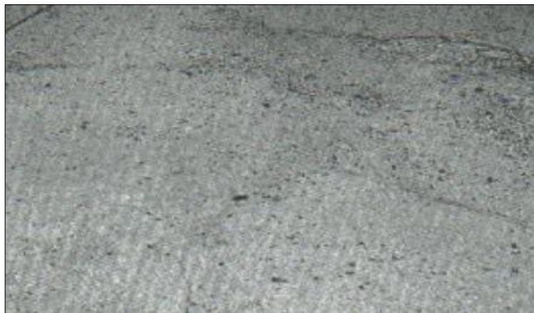
Imagen 19. Losa dividida de alta severidad.
