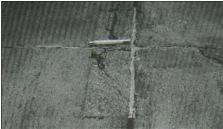
Imagen 37. Parche pequeño de alta severidad.
