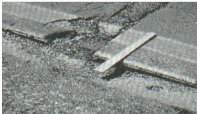
Imagen 26. Desnivel carril / berma de baja severidad.
