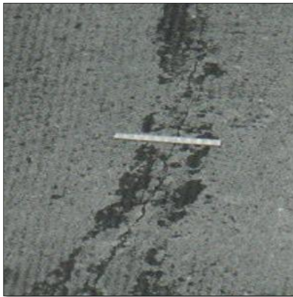
Imagen 29. Grietas lineales de baja severidad en losa de concreto simple.
