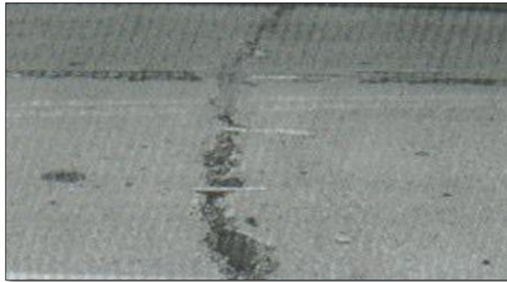
Imagen 31. Grietas lineales de alta severidad en losa de concreto simple.
