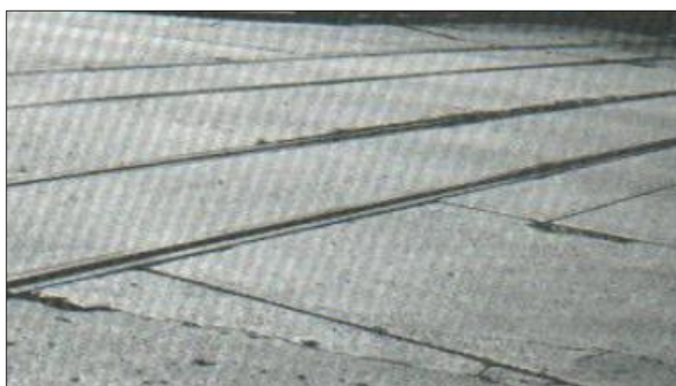
Imagen 44. Cruce de vía férrea de baja severidad.
