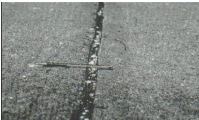
Imagen 25. Daño del sello de junta de alta severidad.
