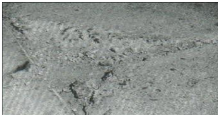
Imagen 53. Descascaramiento de esquina de alta severidad
