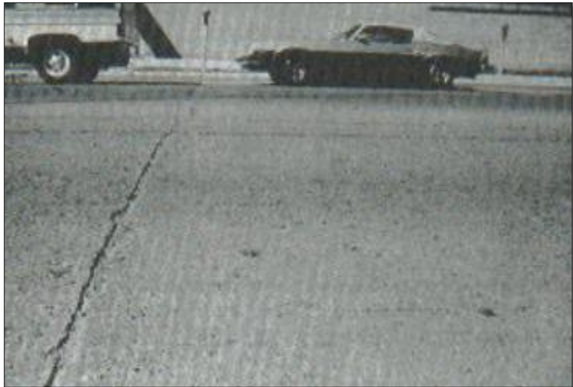
Imagen 54. Descascaramiento de junta de baja severidad.
