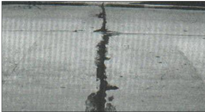
Imagen 23. Daño del sello de junta de baja severidad.
