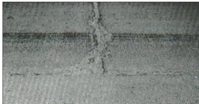
Imagen 52. Descascaramiento de esquina de severidad media..
