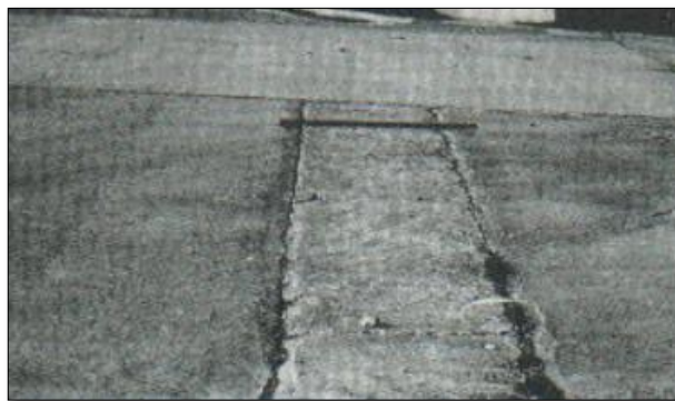
Imagen 33. Parche grande y acometida de servicios públicos de severidad media.
