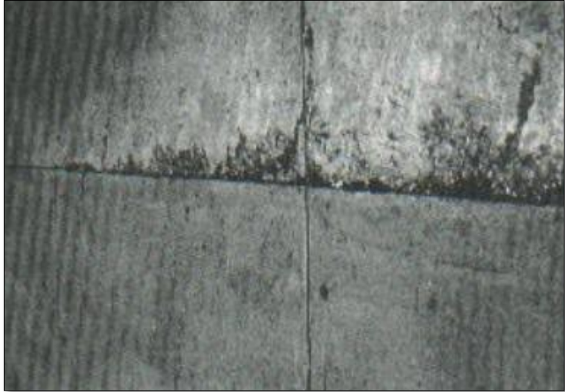
Imagen 55. Descascaramiento de junta de severidad media.
