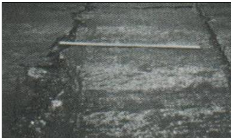
Imagen 34. Parche grande y acometidas de servicios públicos de alta severidad.
