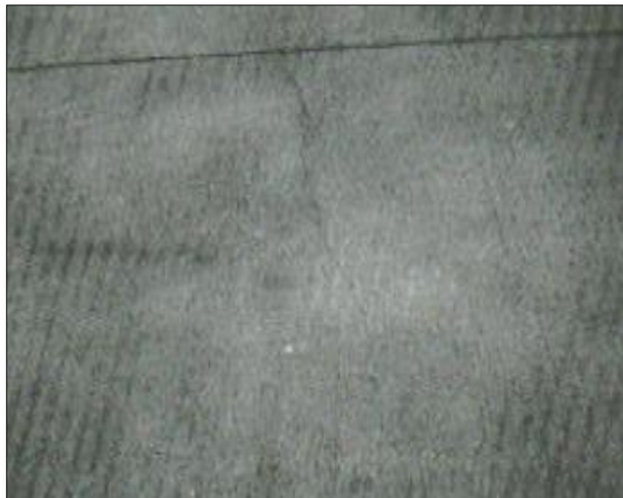
Imagen 50. Grietas de contracción.
