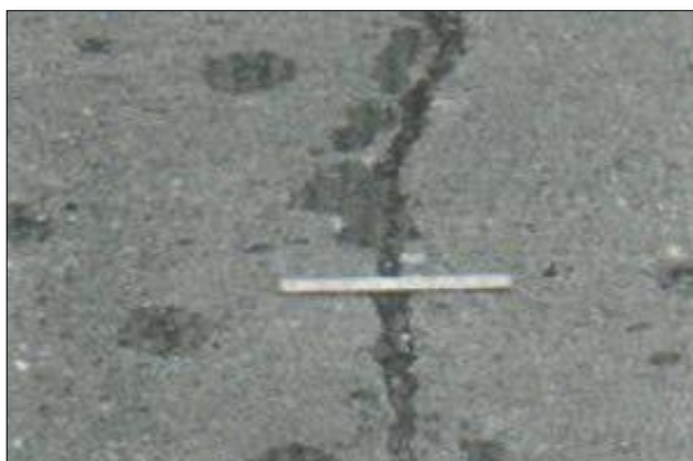
Imagen 30. Grietas lineales de severidad media en losa de concreto reforzado
