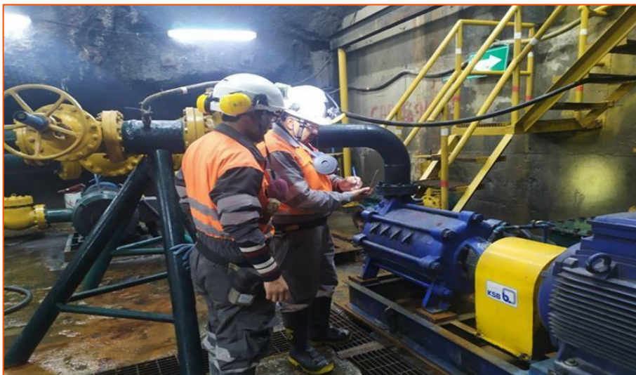
Fotografía 4: Identificación de condición de riesgo, la bomba estacionaria N° 3 no cuenta con guarda de seguridad, con riesgo de soltarse al vibrar – Estación de bombeo del Nv. 3180
