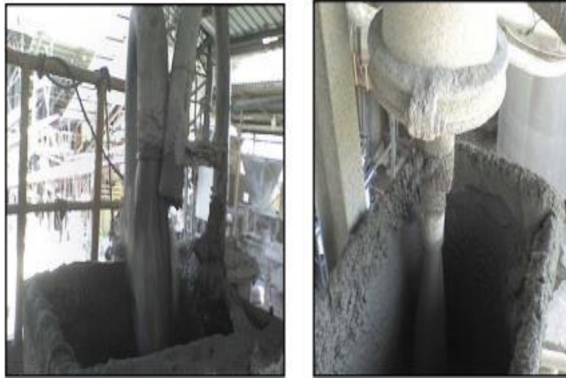
Figura 8 Rebose y descarga del hidrociclón
