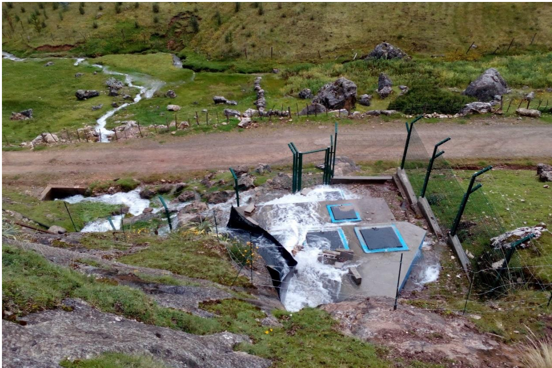
Foto 14: Vista superior de la captación de fuente de agua de ladera del sistema de abastecimiento de agua – “Bellavista”.
