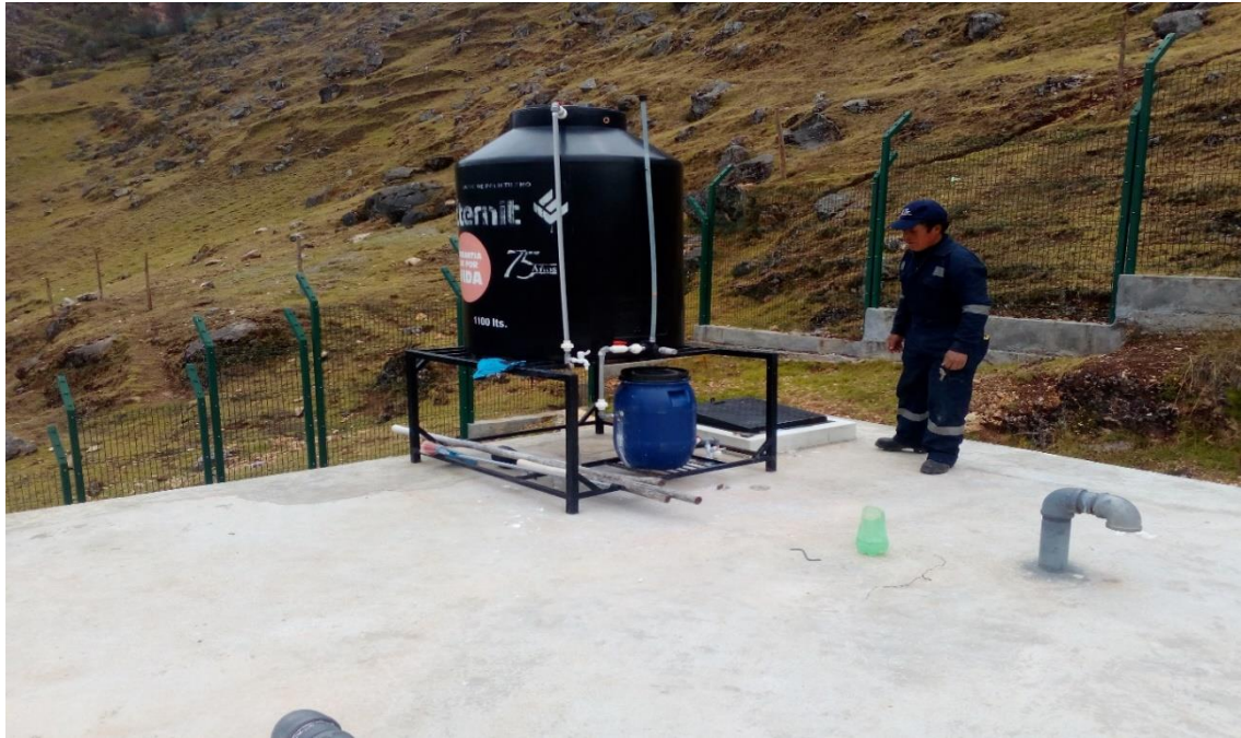
Foto 05: Tesista realizando la evaluación técnica, operativa, toma de datos y georreferenciación en el reservorio del sistema de abastecimiento de agua “Huayruran” – Ticlacayán, con el apoyo del gasfitero del Área técnica Municipal -ATM de la Municipalidad Distrital de Ticlacayan.
