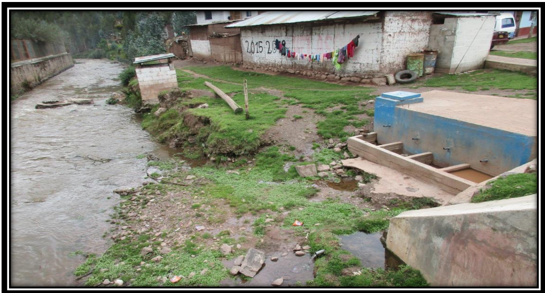
Figura 58 viviendas en peligro de inundación
