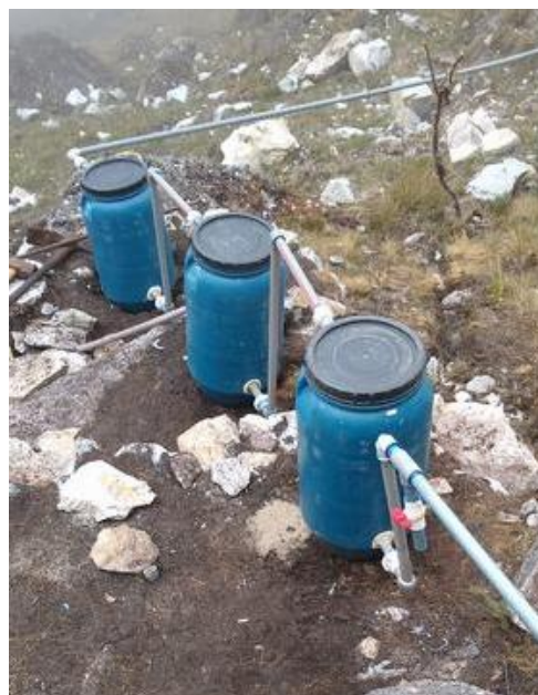
Columnas de carbón activado
