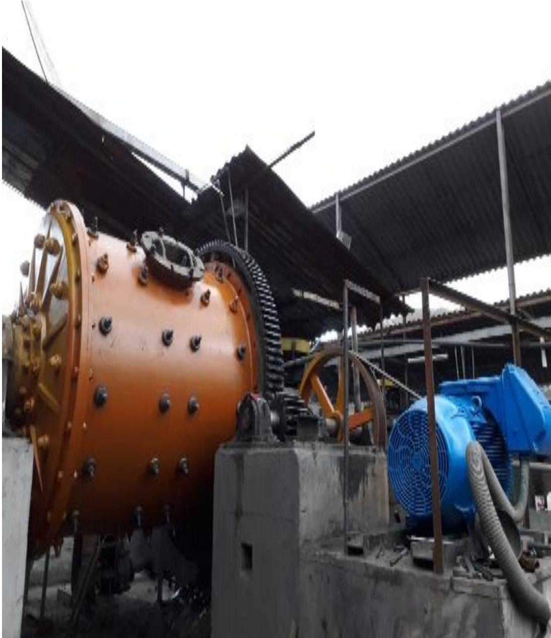
FOTO N° 2: molino de bolas 6' x 6', la cual cuenta en sus operaciones, minera Perú sol
