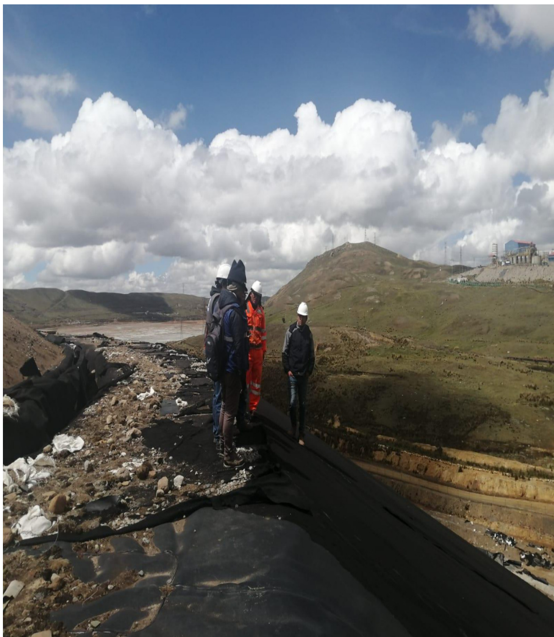
figura 27. Verificación de las áreas afectadas – geosintéticos
