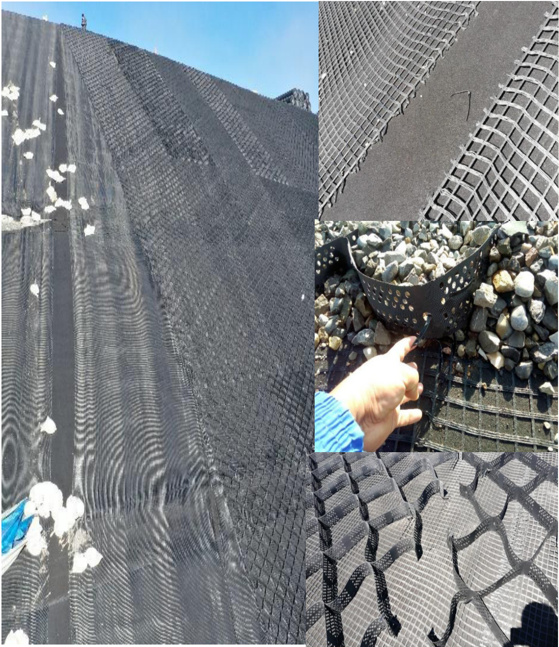
figura 30. Zonas de reforzamiento afectadas
