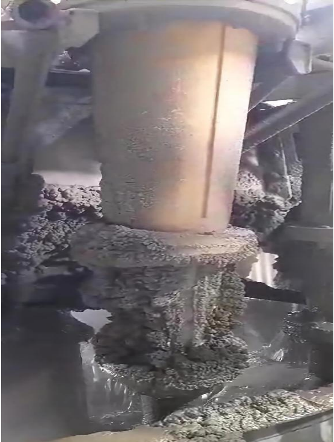
Hidrociclón sin cilindro central
