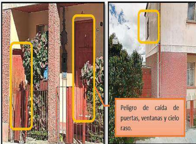
Figura 47. Peligros no estructurales edificación 4.
