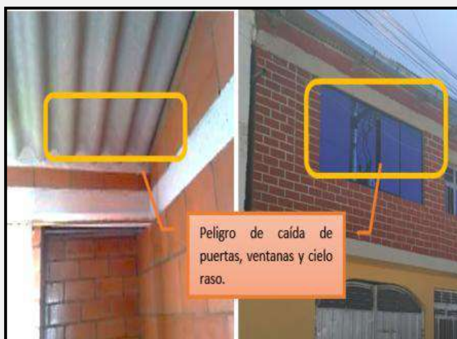
Figura 42. Peligros no estructurales edificación 3.
