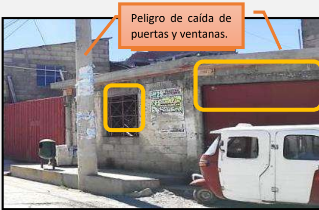
Figura 29. Peligros no estructurales edificación 1.
