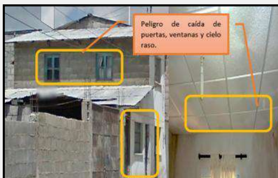
Figura 36. Peligros no estructurales edificación 2.
