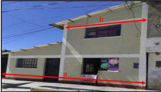
Figura 34. Irregularidad geométrica edificación 2.
