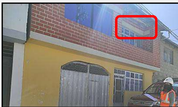
Figura 41. Peligro de caída parapetos edificación 3.
