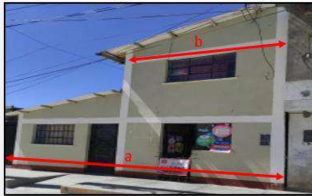
Figura 50. Edificación 2 presencia de golpeo.
