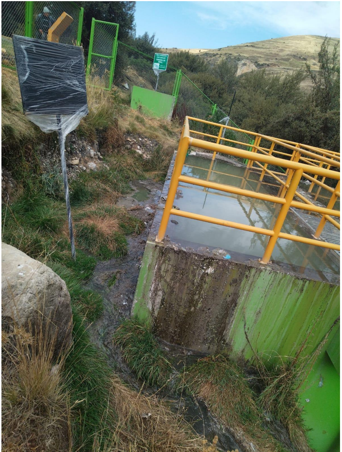
Fotografía 4: Se verifica el rebalse de las aguas residuales en el tanque Imhoff
