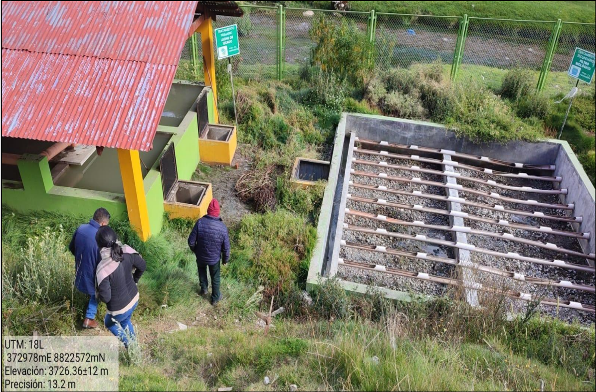
Fotografía 5: Se verificó los componentes de la Planta de Tratamiento de Aguas Residuales en compañía de la población
