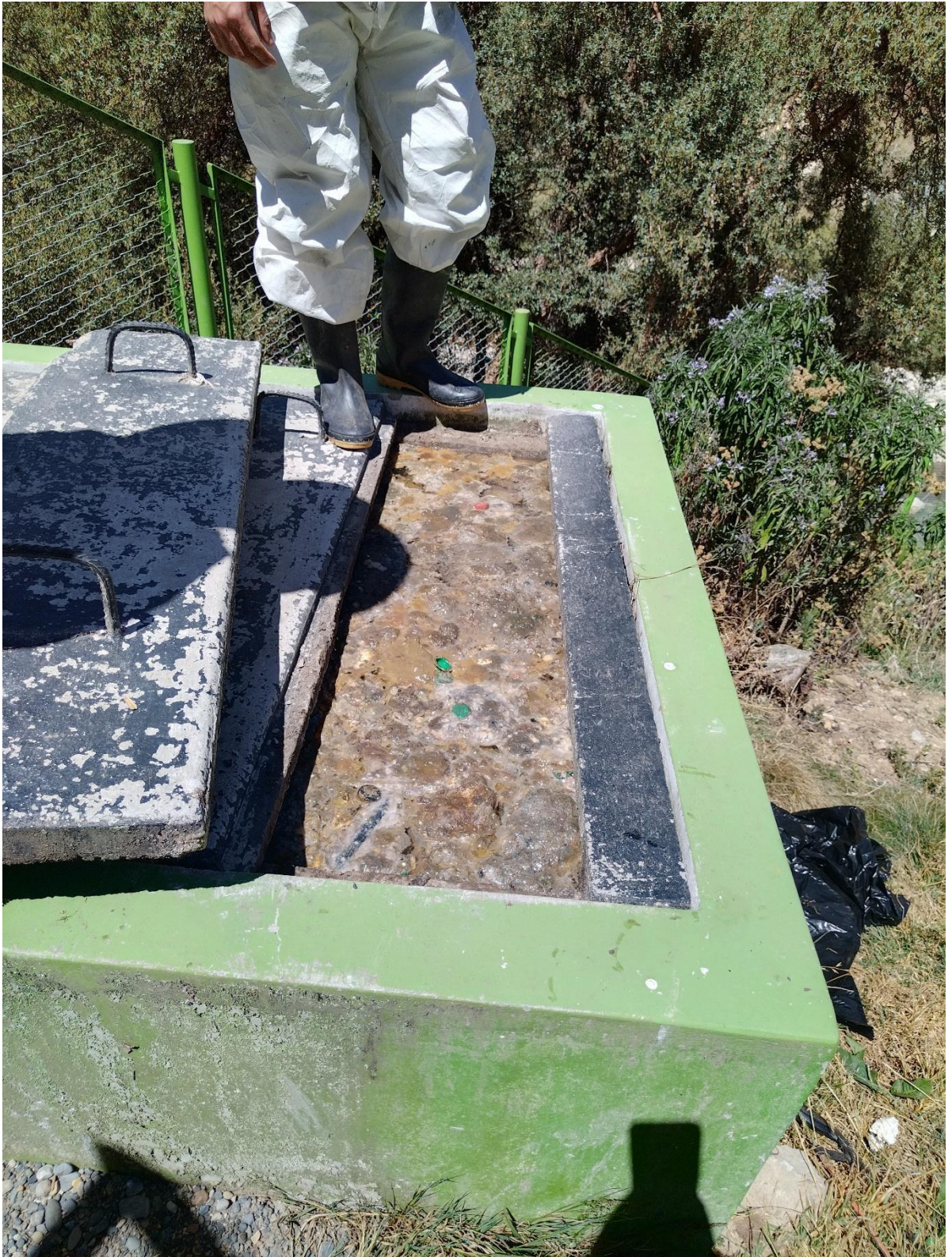
Fotografía 3: Se verifica la acumulación de residuos retenidos en la cámara de rejas.
