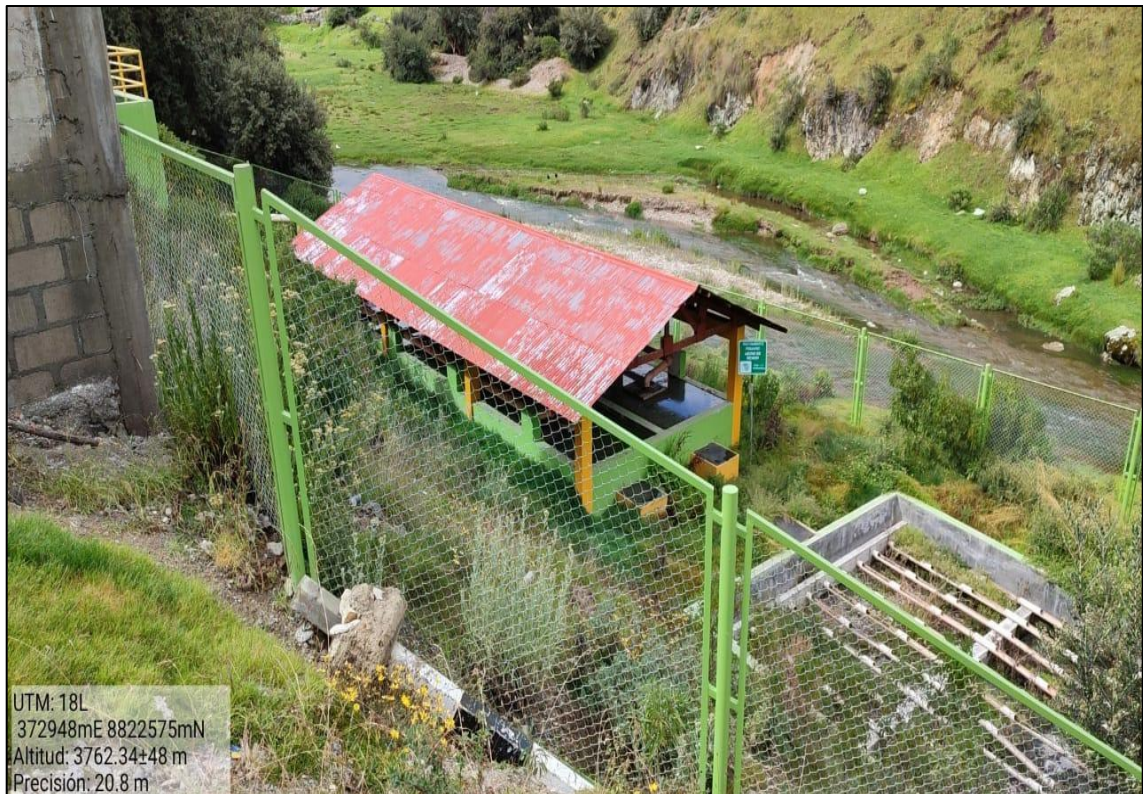
Fotografía 1: Ubicación de la Planta de Tratamiento de Aguas Residuales (Lecho de secado y filtro biológico)
