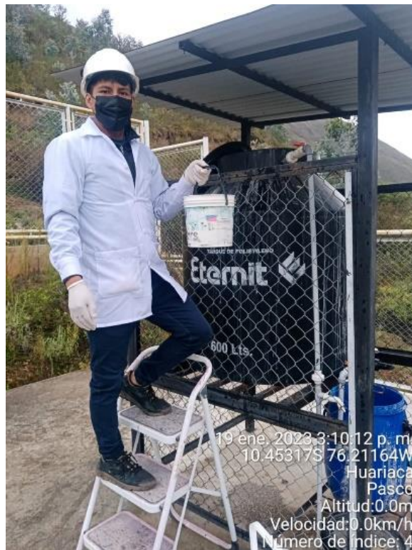
Foto 1. Reservorio donde se realiza la Cloración por goteo
