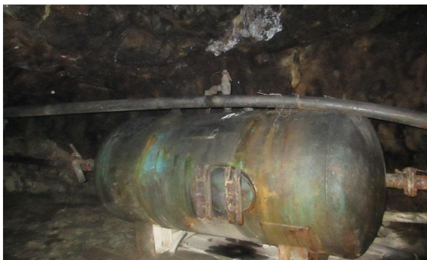
Ilustración 6. Pulmón de Aire Interior Mina Nivel 5
