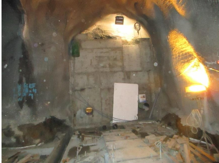
Ilustración 7. Poza de Bombeo Principal Interior Mina Nivel 10
