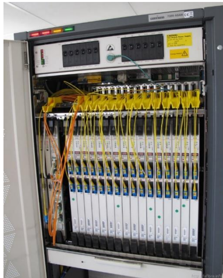
Figura 2 Terminal de Línea Óptica (OLT) marca Alcatel-Lucent.
