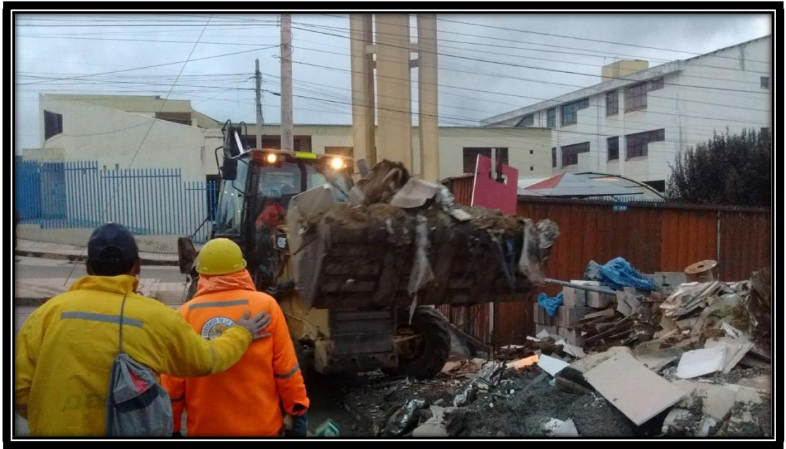
Transporte de Residuos del lugar de acopio de obra, con dirección hacia al botadero Informal en acceso publico, cercano a las viviendas del AA.HH, Columna Pasco.
