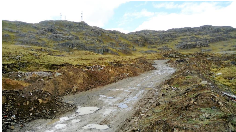
Figura 41. Zona 2 de la Ruta 7 Segundo Botadero Depositados a Todo lo largo y Ambos lados de la Vía.
