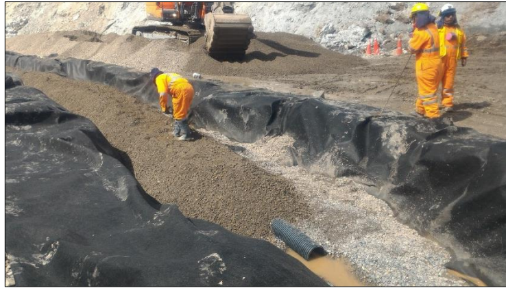
Foto N° 04.- El sistema de subdrenaje consiste esta conformado por un red principal y ramificaciones empleando tubería perforada de 8", filtro estas envueltas en geotextil no tejido.
