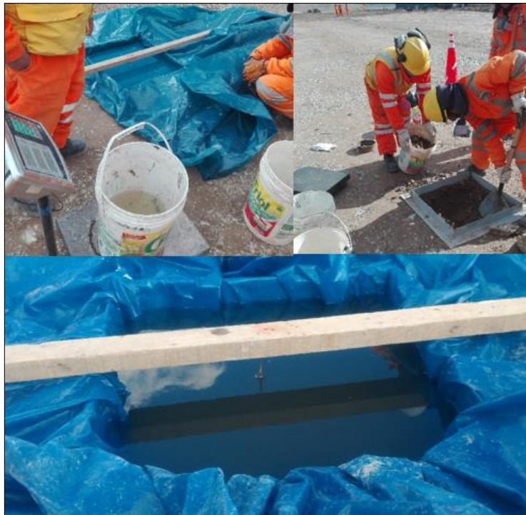
Foto N° 08. - Vista de la realización de los ensayos de campo (reemplazo por agua ASTM D5030), empleando equipos y herramientas de acuerdo a la norma, sujetas a una frecuencia de ensayos de acuerdo a la ingeniería para un espesor de capa de 40 cm, con ello obteniendo densidades insitu que para su aprobación tendrían que superar 95% de grado de compactación.
