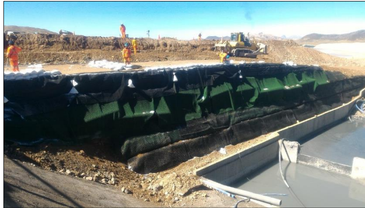
Foto N° 09.- Conformación del refuerzo de talud para la vía nacional, capas compactas más geosintéticos de refuerzo y protección. El personal que piso estuvo en todo momento anclado en un alineamiento de vía por trabajos en altura.
