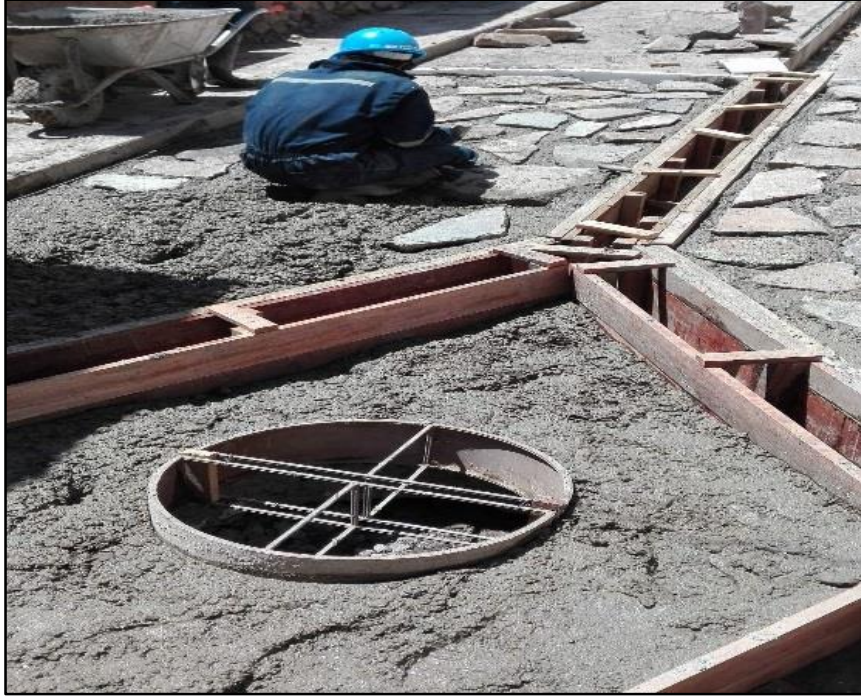
Figura 29M: Encofrado de Buzones y Canaleta más Vaciado de Pavimentos. (Lean Construction) (Fuente: BDC Ingeniería & Construcción E.I.R.L.)
