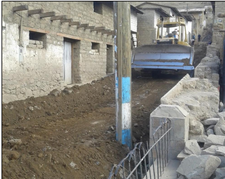
Figura 4M: Corte de Terreno con Maquinaria Pesada. (Fuente: BDC Ingeniería & Construcción E.I.R.L.)
