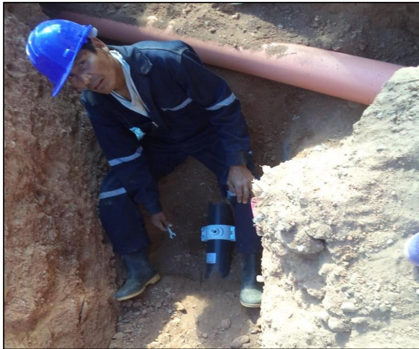
Figura 8M: Reposición de Conexiones Domiciliarias en el Sistema de Agua Potable. (Fuente: BDC Ingeniería & Construcción E.I.R.L.)
