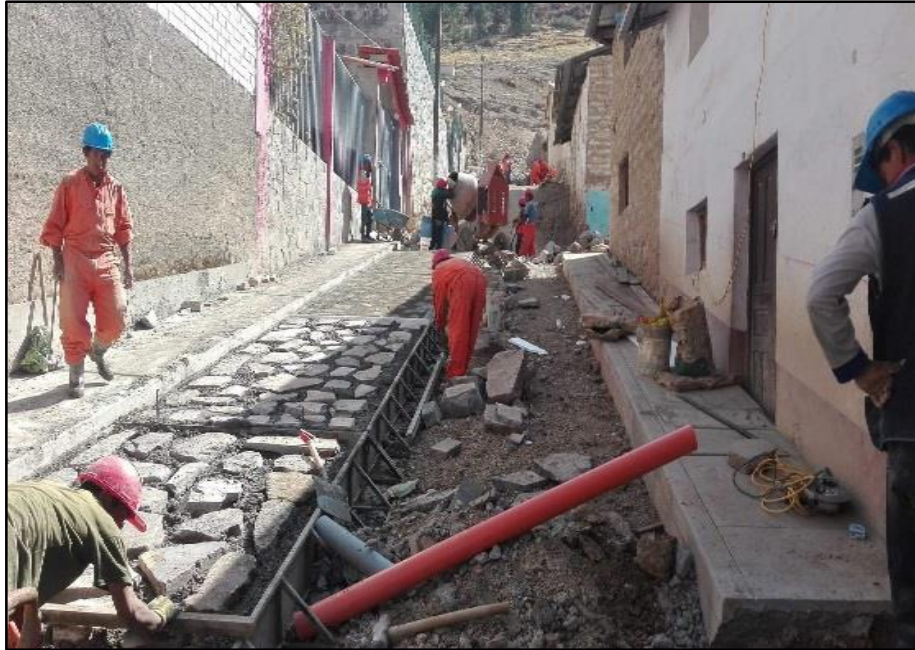
Figura 21M: Desorden en Trabajos de Vaciado. (Tradicional) (Fuente: BDC Ingeniería & Construcción E.I.R.L.)
