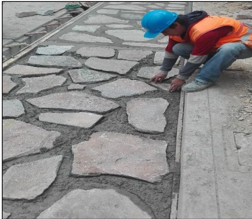
Figura 30M: Colocación de Piedras Grandes y Nivelación de Calzada de Pavimento. (Lean Construction) (Fuente: BDC Ingeniería & Construcción E.I.R.L.)
