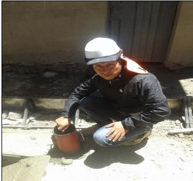
Figura 27M: Sacado de Muestras de Probetas de Concreto. (Lean Construction) (Fuente: BDC Ingeniería & Construcción E.I.R.L.)
