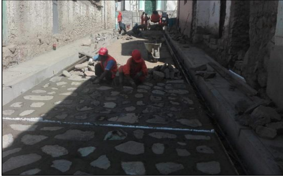
Figura 31M: Colocación de Piedra Grande en Pavimento. (Lean Construction) (Fuente: BDC Ingeniería & Construcción E.I.R.L.)
