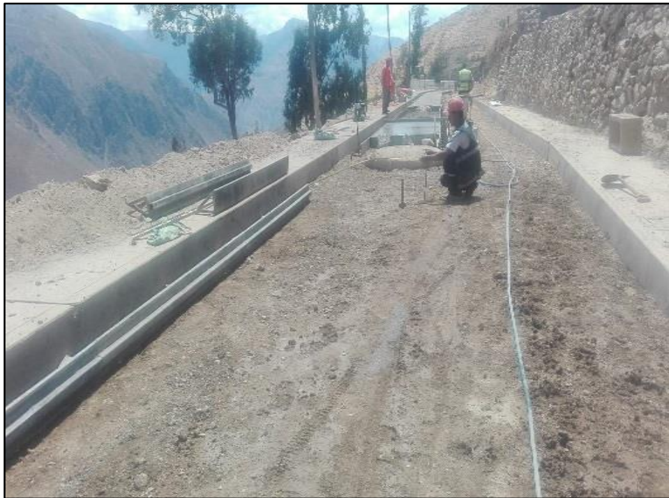
Figura 14M: Encofrado Metálico en Pavimento Rígido. (Tradicional) (Fuente: BDC Ingeniería & Construcción E.I.R.L.)
