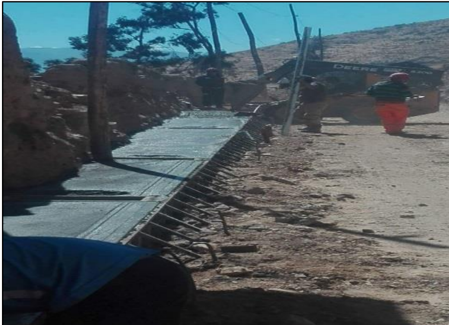
Figura 38M: Vaciado y Acabado en Veredas. (Tradicional) (Fuente: BDC Ingeniería & Construcción E.I.R.L.)
