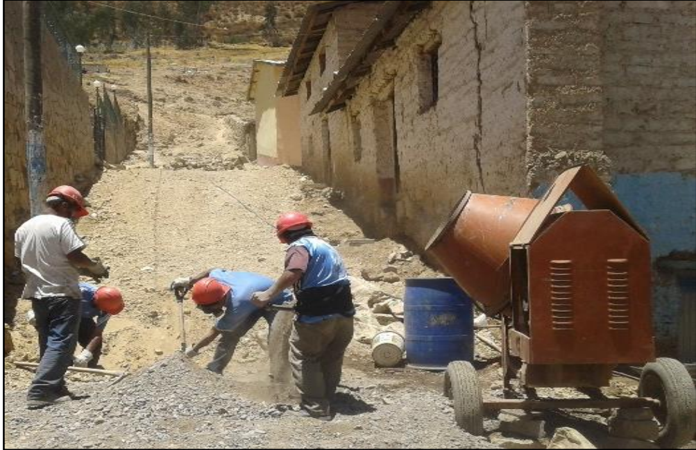
Figura 25M: Llenado de Agregado a la mezcladora de Concreto. (Lean Construction) (Fuente: BDC Ingeniería & Construcción E.I.R.L.)
