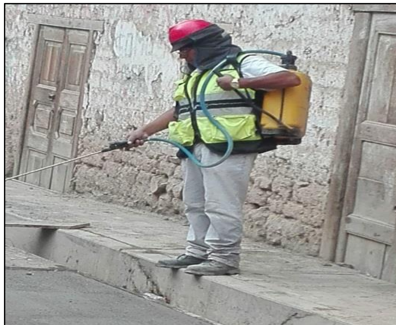
Figura 28M: Curado del Concreto Rígido del Pavimento. (Lean Construction) (Fuente: BDC Ingeniería & Construcción E.I.R.L.)
