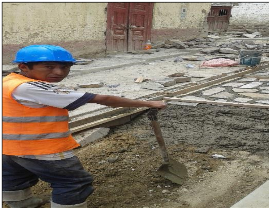
Figura 22M: Vaciado del Concreto en Pavimentos con Empedrado. (Tradicional) (Fuente: BDC Ingeniería & Construcción E.I.R.L.)
