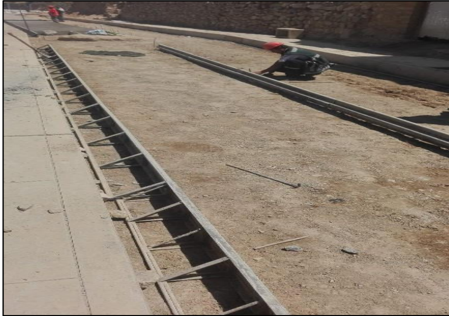
Figura 23M: Encofrado Metálico en Pavimentos. (Lean Construction) (Fuente: BDC Ingeniería & Construcción E.I.R.L.)
