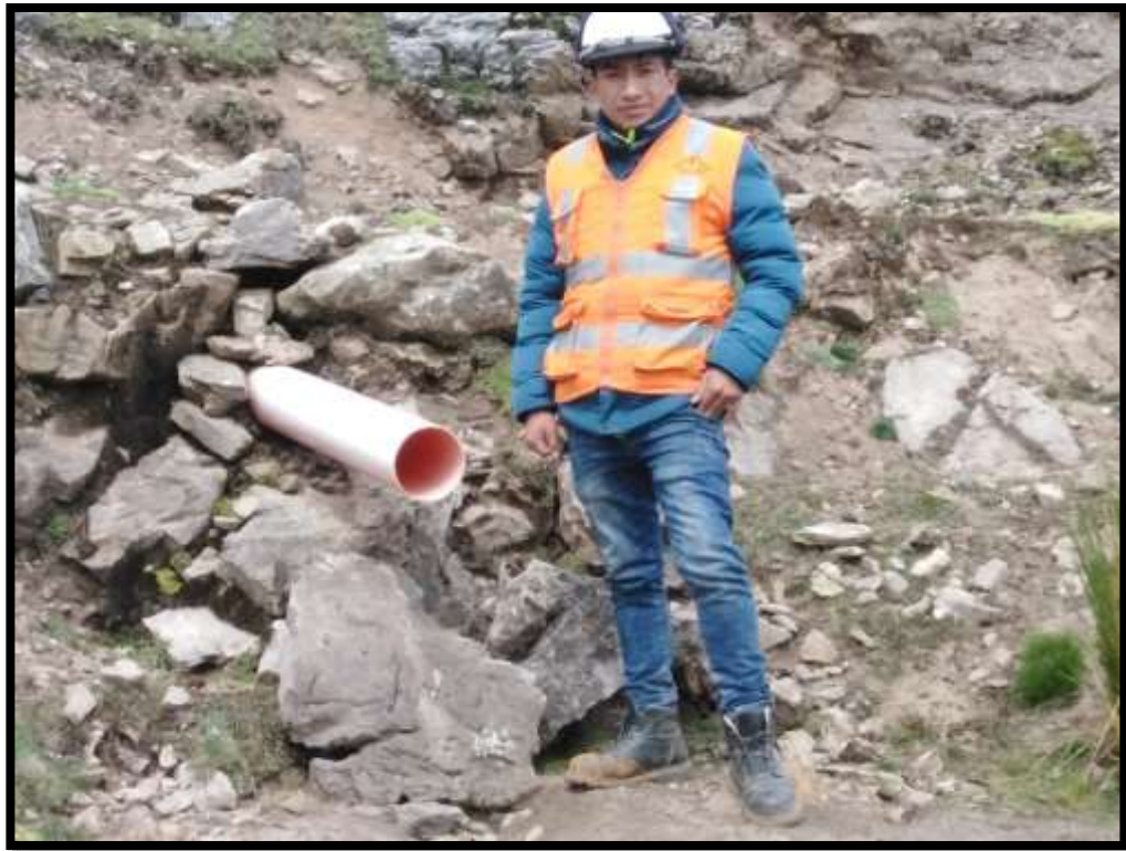
Fotografía N°19: Instalaciones para el drenaje de aguas
