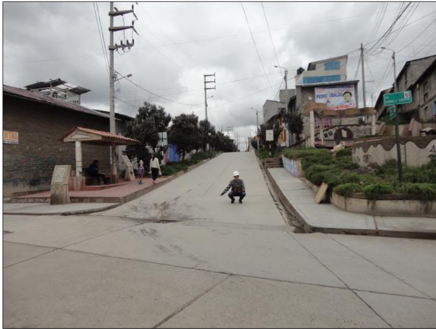
Imagen 120. 7ma cuadra (Intersección Av. Daniel Alcides Carrión con Av. Perú) – Existe Marcas en el pavimento. FUENTE: Propia
