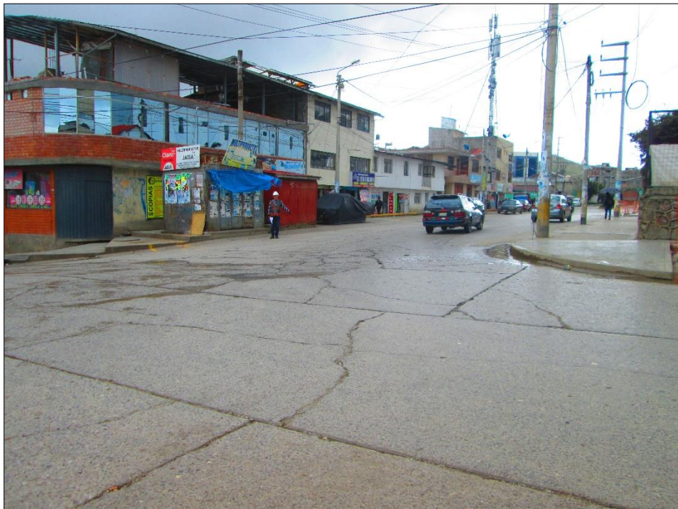
Imagen 117. 5ta cuadra (Intersección Av. Daniel Alcides Carrión con Av. Los incas) – No existe ningún tipo de señalización. FUENTE: Propia
