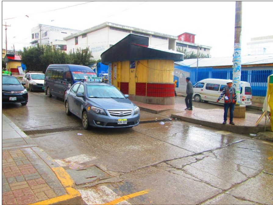
Imagen 112. 4ta cuadra (Intersección Av. Daniel Alcides Carrión con Av. Los Próceres) – Se puede ver marcas en el pavimento en mal estado.
