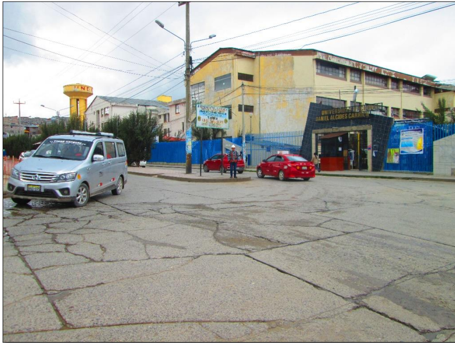
Imagen 114. 5ta cuadra (Intersección Av. Daniel Alcides Carrión con Av. Los incas) – No existe ningún tipo de señalización. FUENTE: Propia
