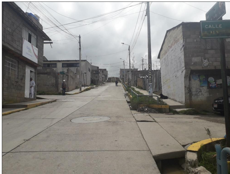
Imagen 129. 11ava cuadra (Intersección Av. Daniel Alcides Carrión con Calle Lima) – Existe señalización informativa en regular estado. FUENTE: Propia
