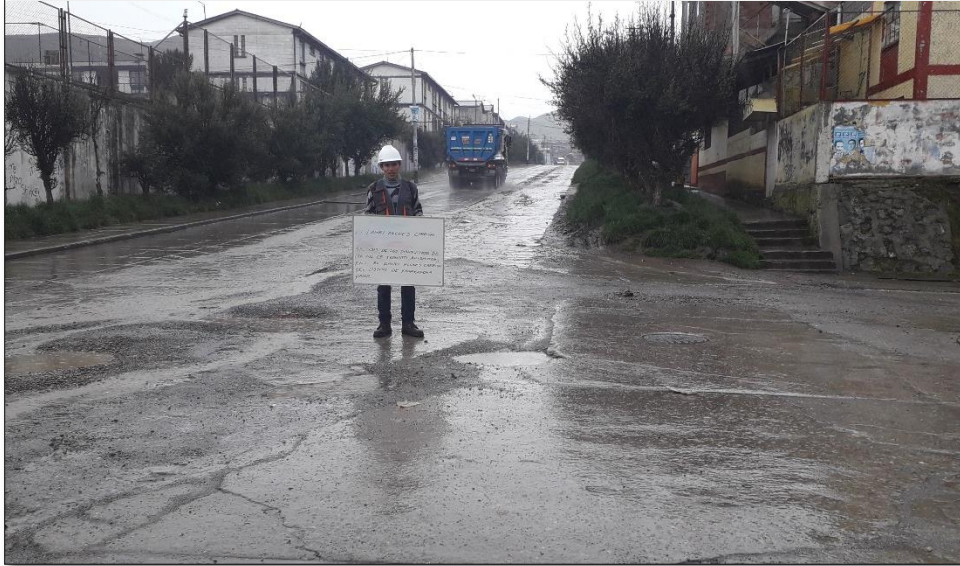
Imagen 1012. Inicio del trabajo de tesis (Intersección Av. Daniel Alcides Carrión con Av. Simón Bolívar) – No existe ningún tipo de señalización.
