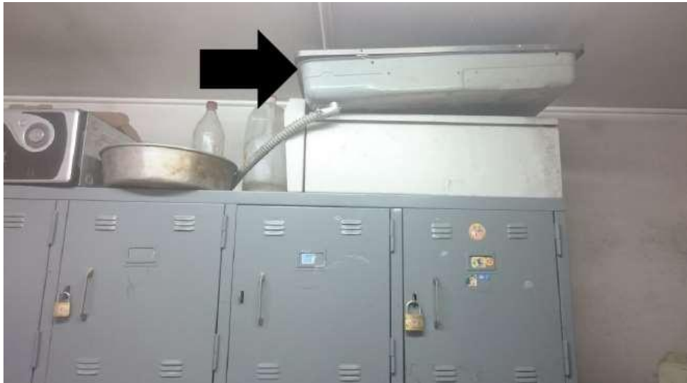
01 cocina eléctrica de cuatro hornillas (Operativo)
