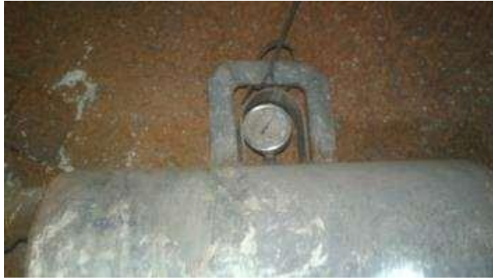
Manómetro Ubicado En El Pulmón De Aire
