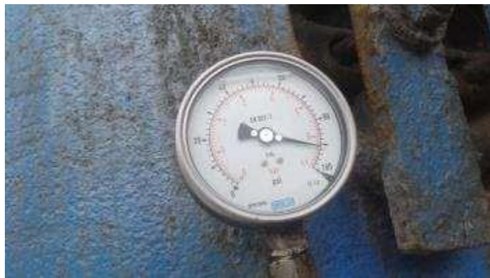
Manómetro Ubicado En El Pulmón De Aire
