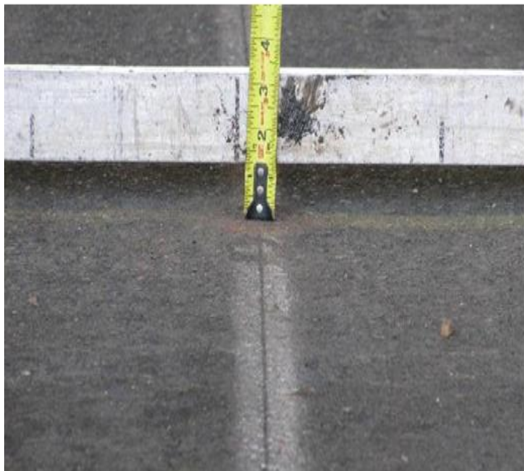
Figura 28. Medición del ahuellamiento (TENSAR, 2009)
