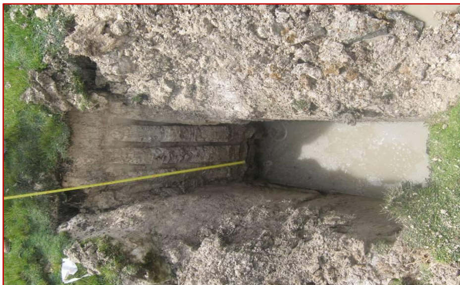
SE OBSERVA LA PRESENCIA DEL NIVEL FREATICO A 1.60 M.
