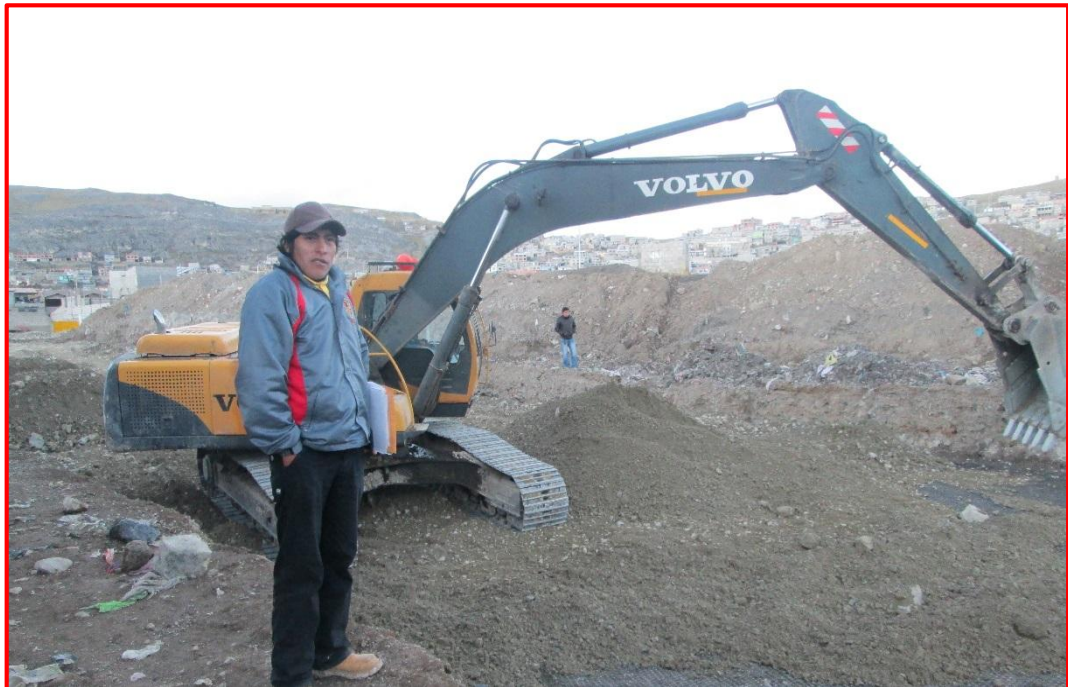
Se observa el reemplazo del material de afirmado en la Av. Los Insurgentes
